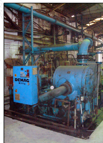
Pompe Wittig WPSO sostituite
