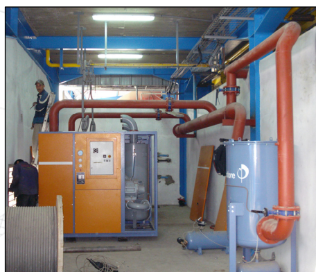
Sala máquinas con 2 x UV30 en 2010
